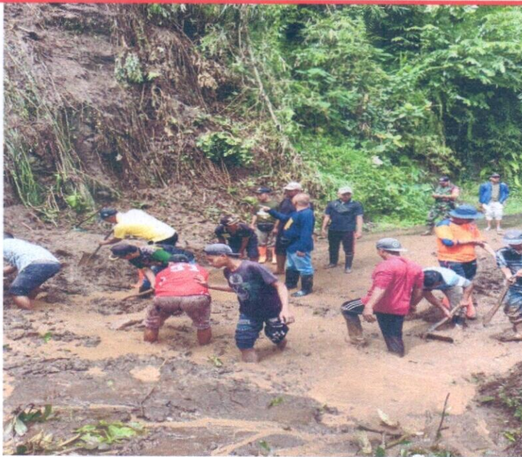
Kerja bakti penanganan tanah longsor
